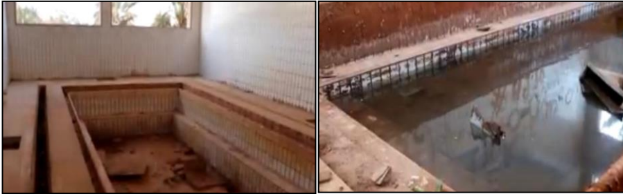
الصورة (4) البنى التحتية وما أصابها من التعدي والتخريب // المصدر: تقرير لقناة الوطنية.
