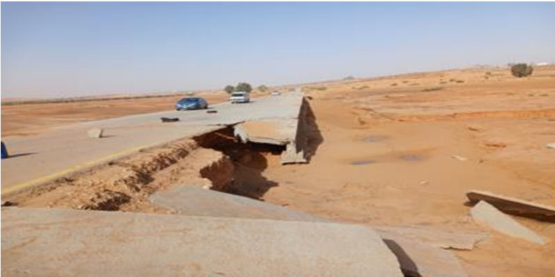
تآكل الطريق العام جنوب مدينة ترهونة
